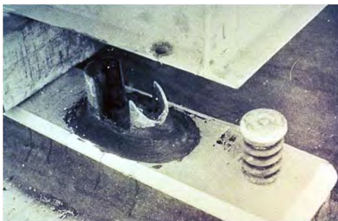
شکل ۹-۱۰ - آسیب وارده به جداگر فنری در زلزله
