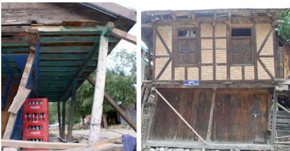
شکل ۹-۳۶ تغییرشکل جانبی دائم سازه به علت عدم وجود بادبندهای مناسب و یا اتصالات ضعیف بادبندها
