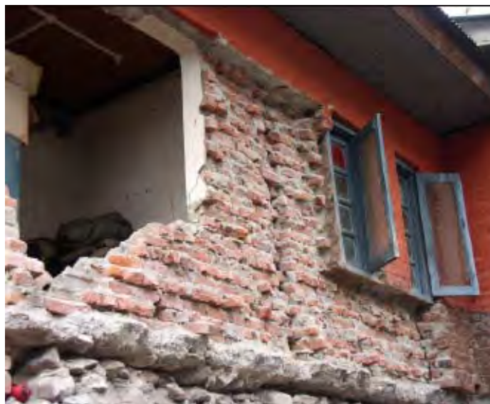
شکل ۹-۶ نمونه‌ای از خرابی خارج از صفحه دیوارهای بنایی
