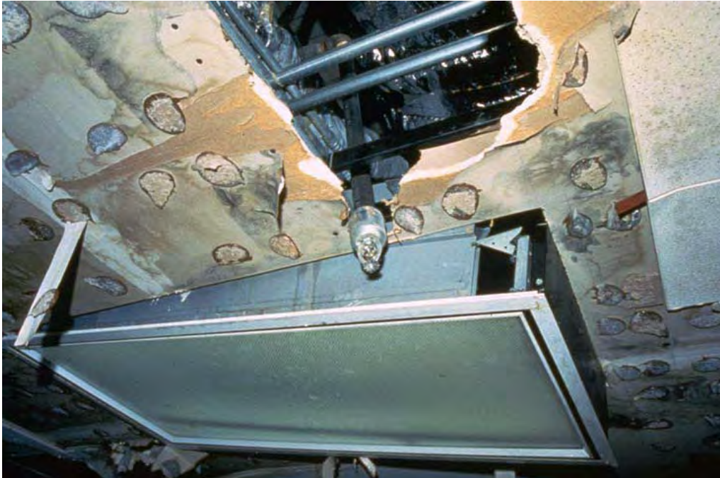
شکل ۱۰-۱۱ - آسیب وارده به تاسیسات مکانیکی بالای سقف کاذب
