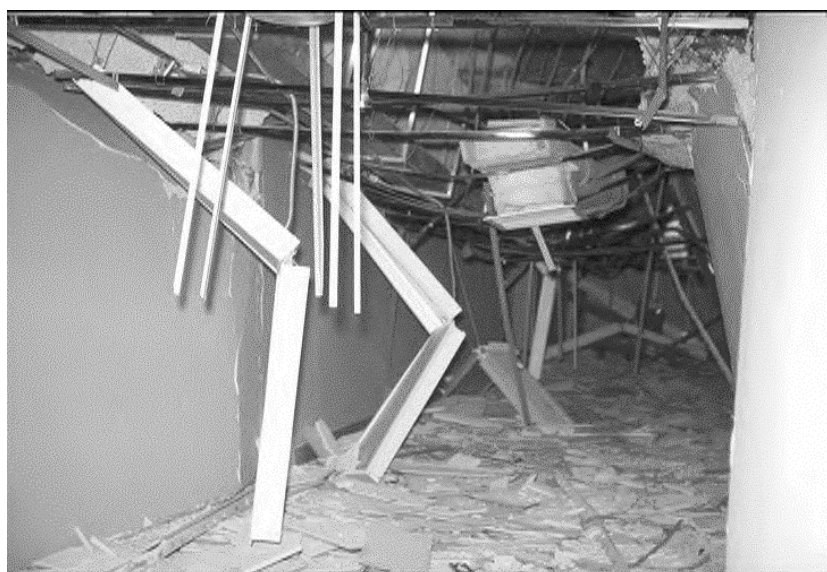
شکل ۱۰-۱۳ - نمونه‌ای از آسیب وارده به وسایل روشنایی در زلزله
