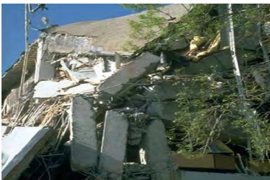
شکل ۲-۶-۵ نمونه‌هایی از شکست در اتصالات ضعیف بتنی
