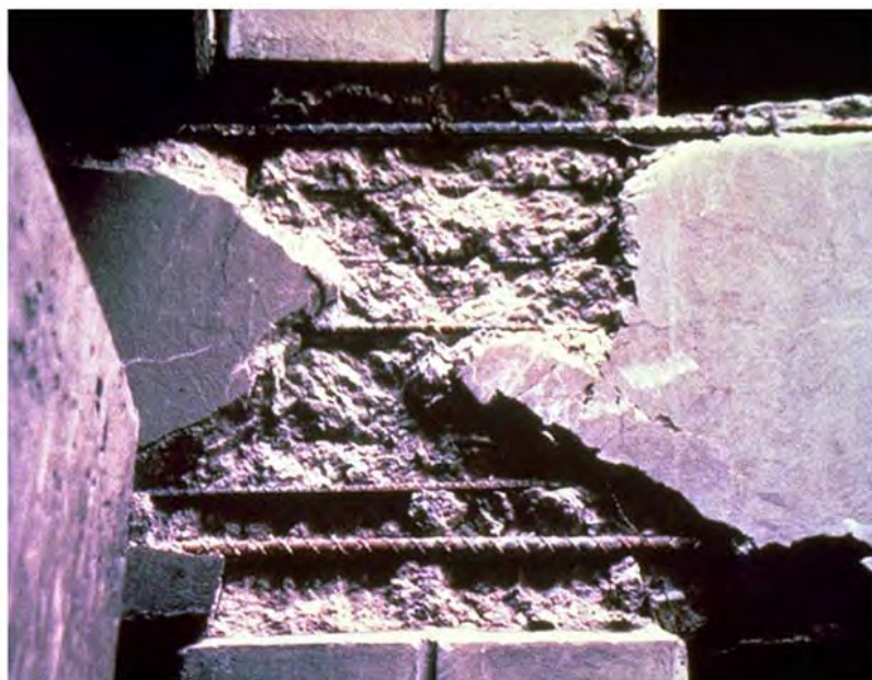
شکل ۲-۶-۸ کمانش میلگردهای طولی تیر در ناحیه اتصال
