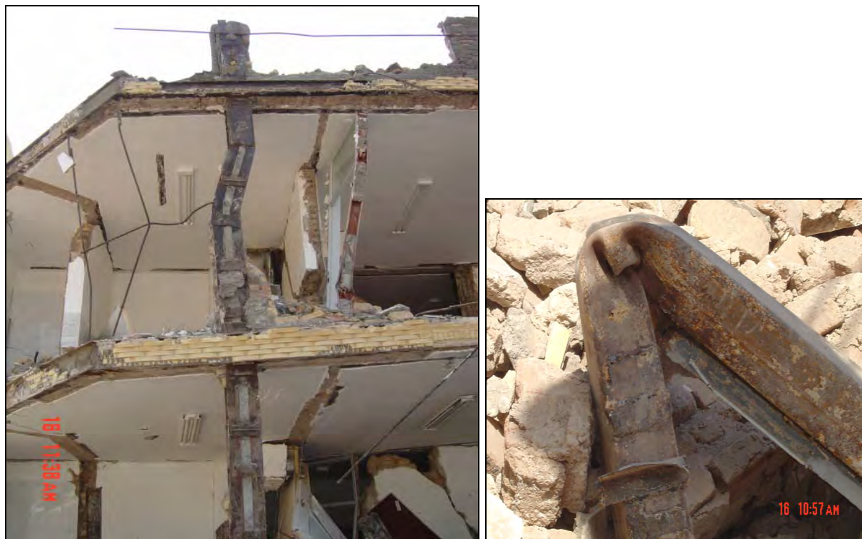
شکل ۲-۵-۱۹- نمونه‌ای از خرابی ستون‌های فولادی
