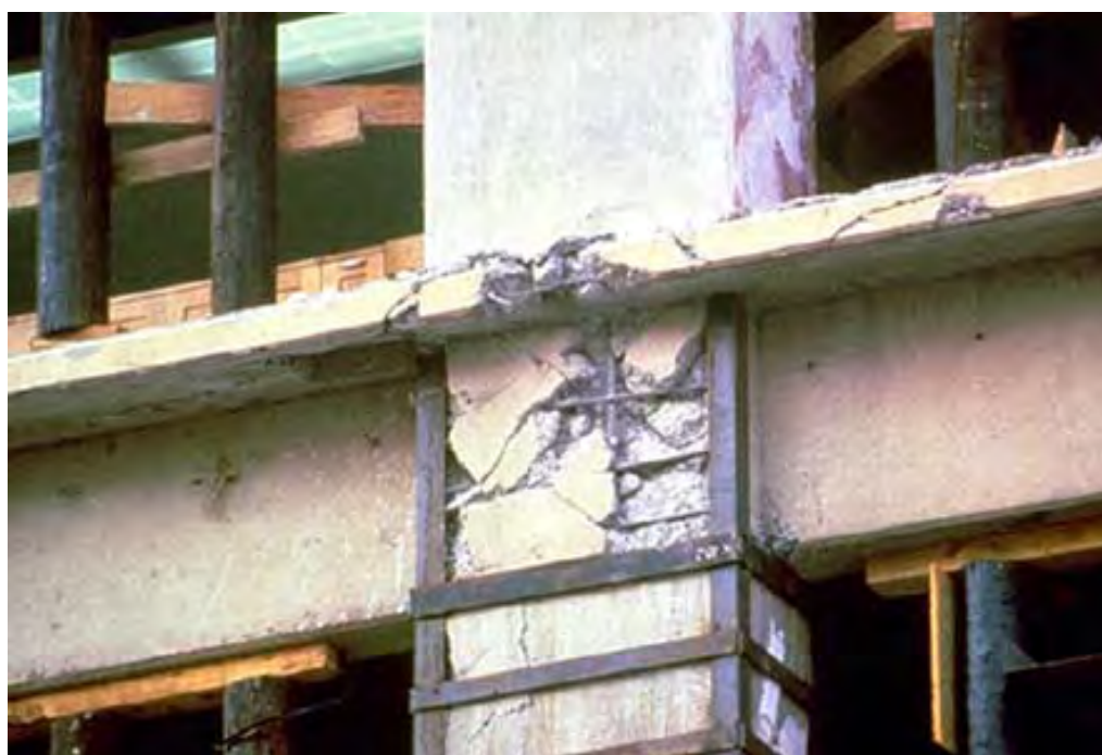
شکل ۲-۶-۷ کمانش میلگردهای طولی ستون در ناحیه اتصال
