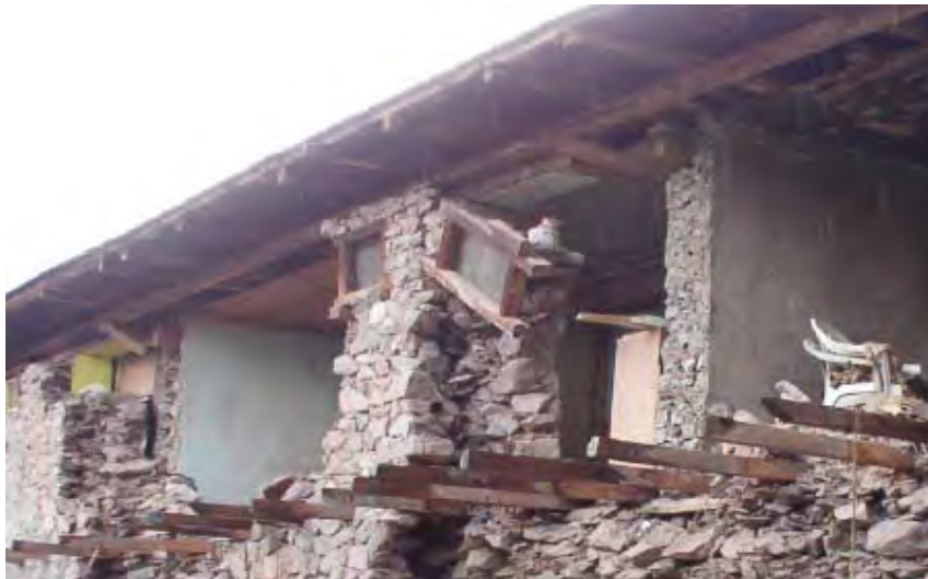
خرابی به علت ضعف در مقاومت خمشی دیوارهای بنایی
