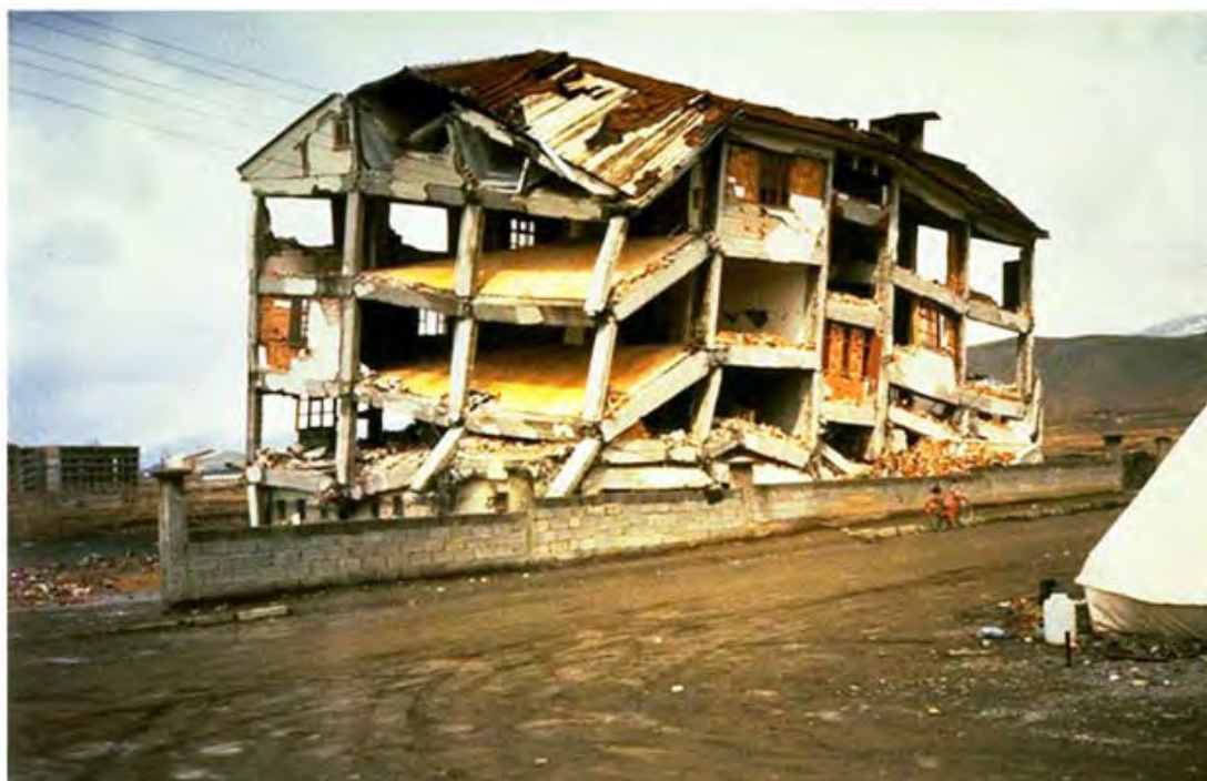
شکل ۲-۶-۱۲ تخریب اتصال در اثر کمبود میلگرد طولی که منجر به تخریب کلی سازه شده است.
